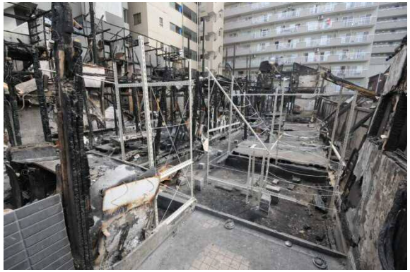
写真4 出火箇所の復元（1階ホール）
