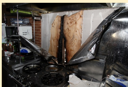
壁内の合板の損傷状況
