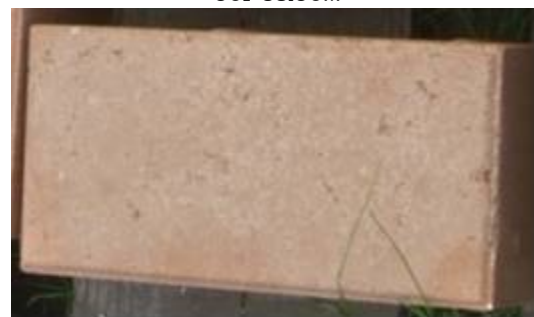
写真 2 エフロレッセンス発生状況
